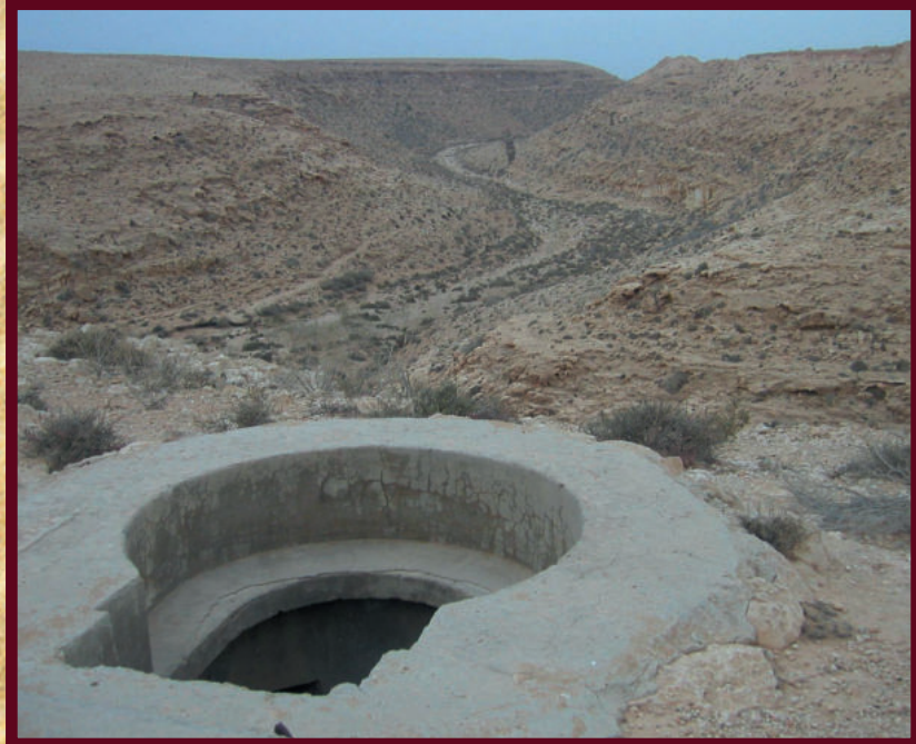
Zde udělali italští stavitelé chybu: Stropními vchody do pevnostní linie v Tobruku při nečekané průtrži mračen snadno vnikala voda
