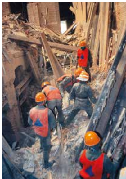
Odklizení trosk zkolabované budovy v důsledku ničivých účinků živelní pohromy.
